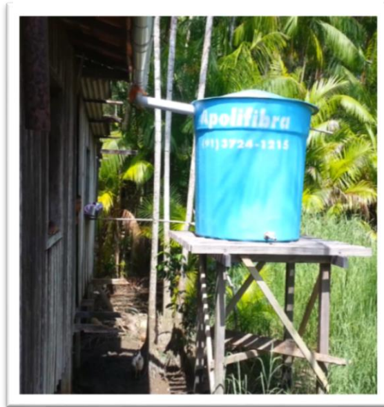
Figura 8 - Sistema de abastecimento com uso da água de chuva na ilha Jutuba instalado pela Cáritas
