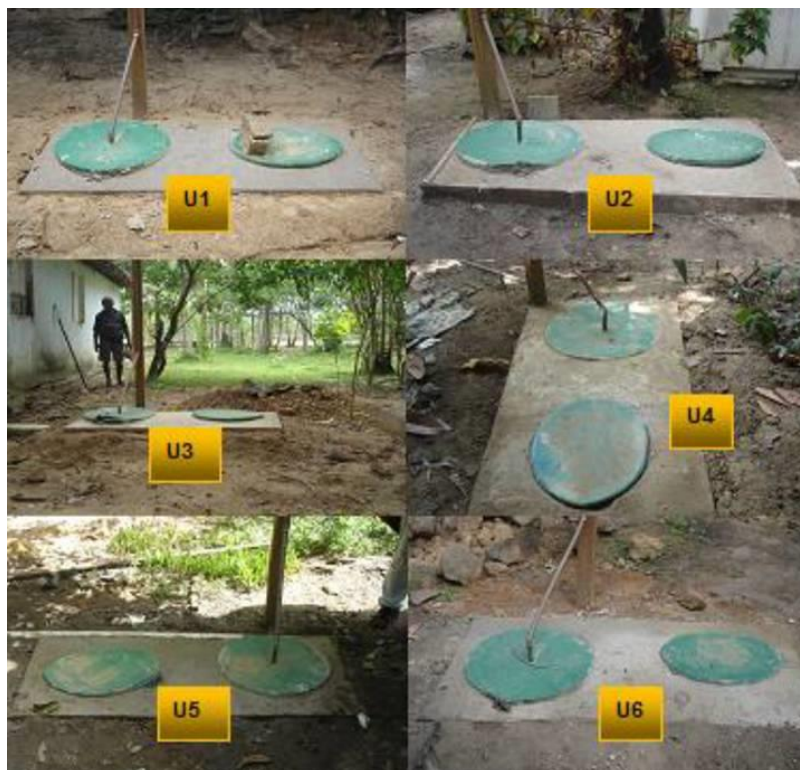
Figura 18 - Reatores UASB em comunidades rurais em área de terra firme.
