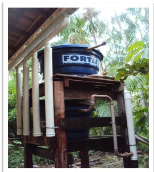
Figura 7 - Sistema de Abastecimento com uso da água de chuva na ilha Grande instalado pelo GPAC Amazônia/UFPA
