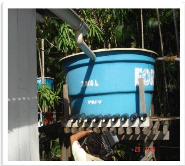
Figura 9 - Sistema de abastecimento com uso da água de chuva na ilha Paquetá instalado pela Cáritas
